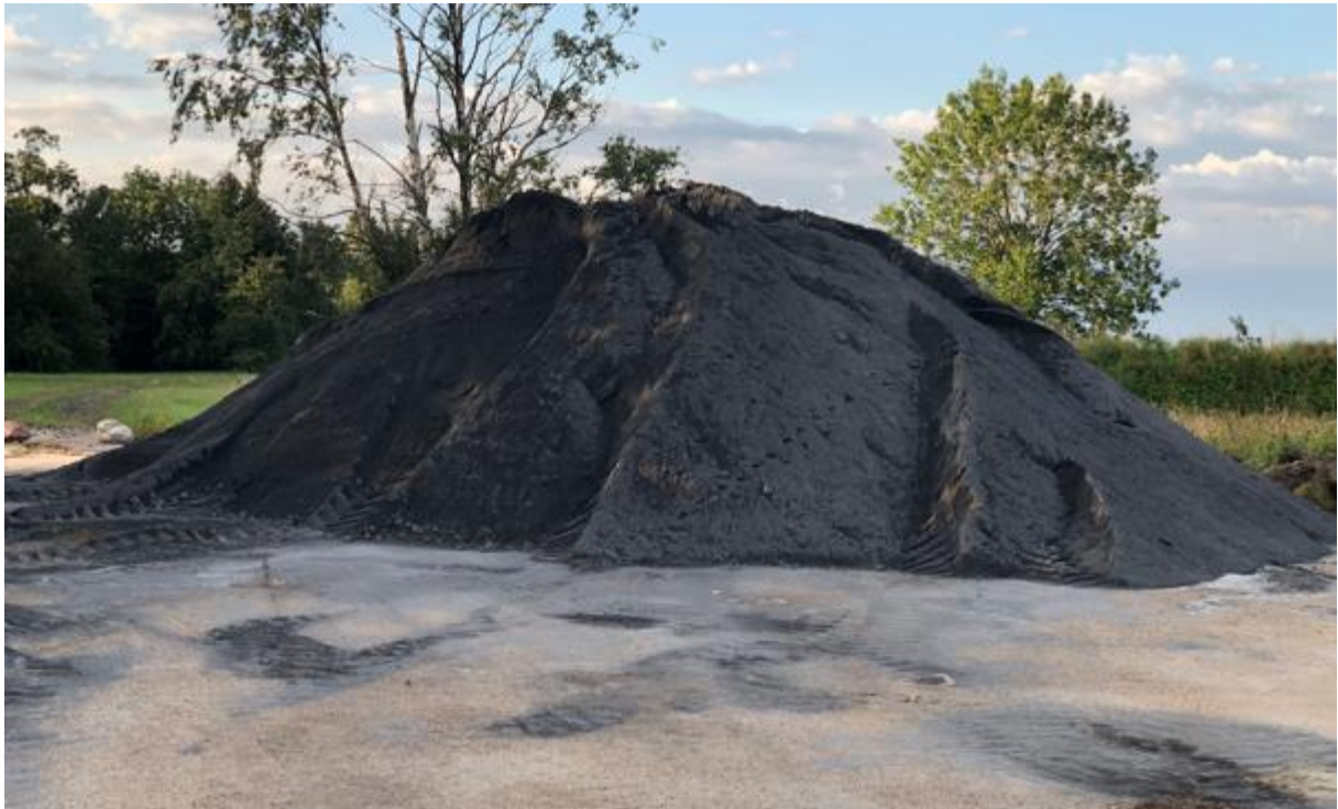
Kalk anländer till projektet och lagras på platta i anslutning till aktuellt fält
